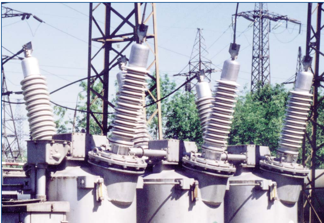
■ Вводы 110 кВ/2000 А с фарфоровой изоляцией.
