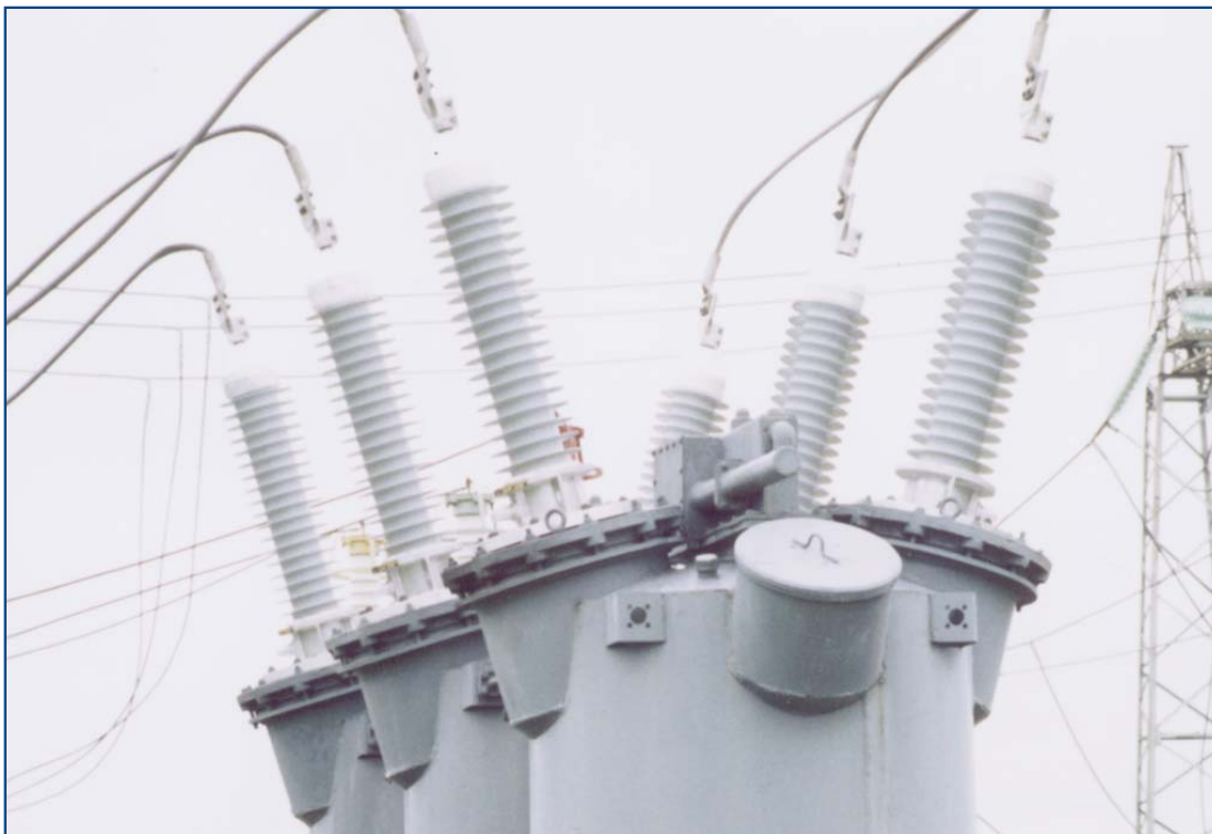
■ Вводы 110 кВ/2000 А с полимерной изоляцией.
